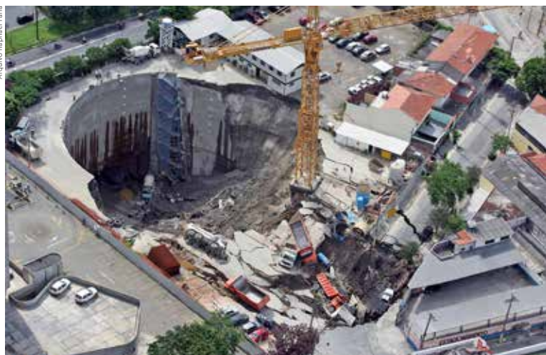
Acidente em obra de escavação
