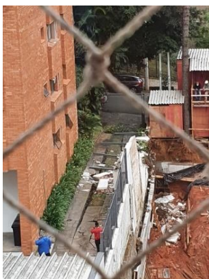
Figura 1. Foto após o rompimento onde é possível observar impactos ao vizinho.
