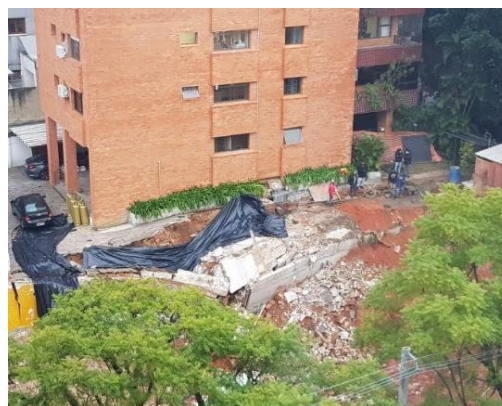
Figura 2. Foto após o rompimento.
