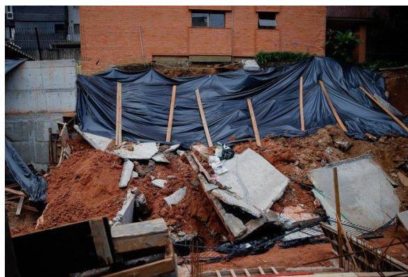
Figura 4. Foto após o rompimento obtida a partir do terreno da obra.
