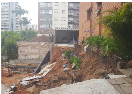
Figura 3. Foto após o rompimento obtida a partir do terreno vizinho.
